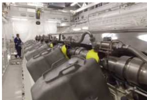
Der Maschinenraum der »AIDAnova« (Foto: Eckardt)
